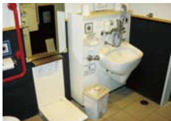
オストメイト対応設備
