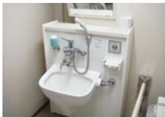
オストメイト対応設備
