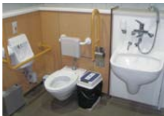
オストメイト対応設備
