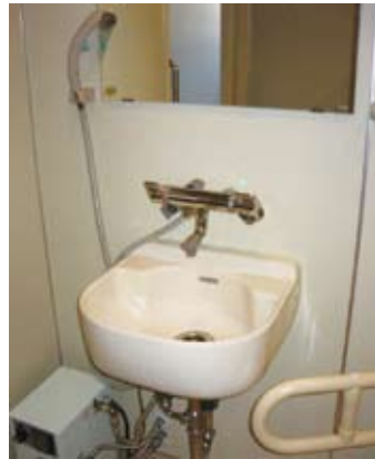
オストメイト対応設備
