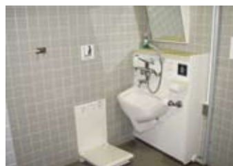
オストメイト対応設備
