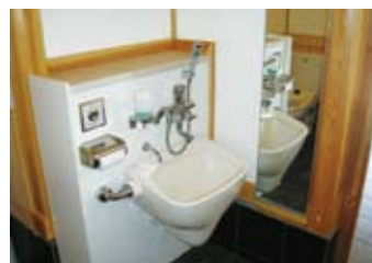
オストメイト対応設備
