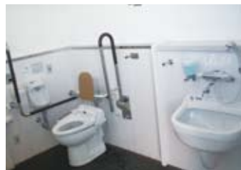
オストメイト対応設備
